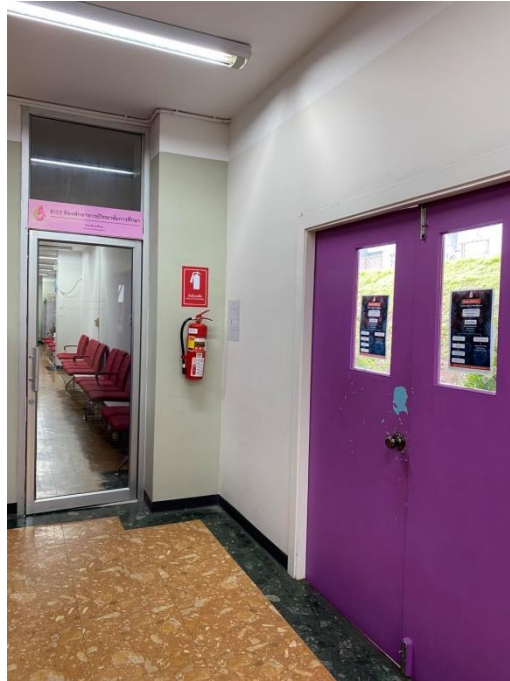
จุดติดตั้งถังดับเพลิง จุดที่ 3 บริเวณห้องผู้บริหารวิทยาลัยการศึกษ [B102]
