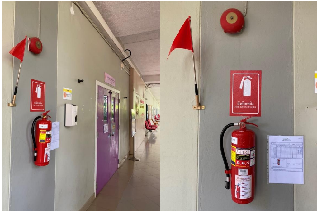
จุดติดตั้งถังดับเพลิง จุดที่ 1 บริเวณหน้าสำนักงานวิทยาลัยการศึกษา [B101]
