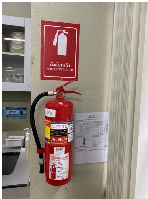
จุดติดตั้งถังดับเพลิง จุดที่ 2 บริเวณห้องครัวห้องสำนักงานวิทยาลัยการศึกษา [B101]
